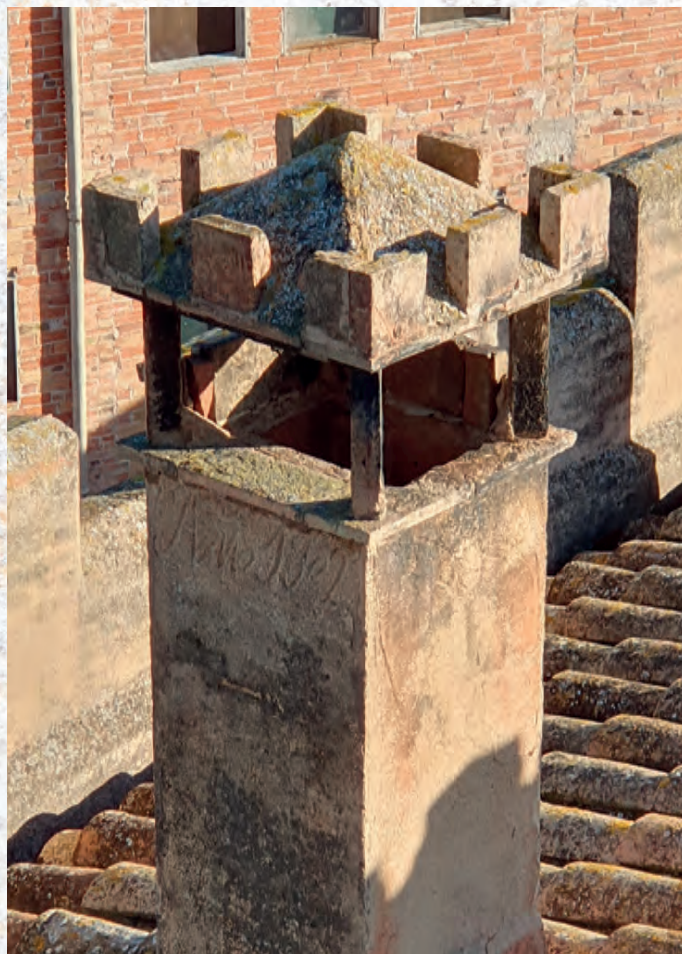
Detall data 1902 en una de les xemeneies. Foto: Pep Ulldemolins.
