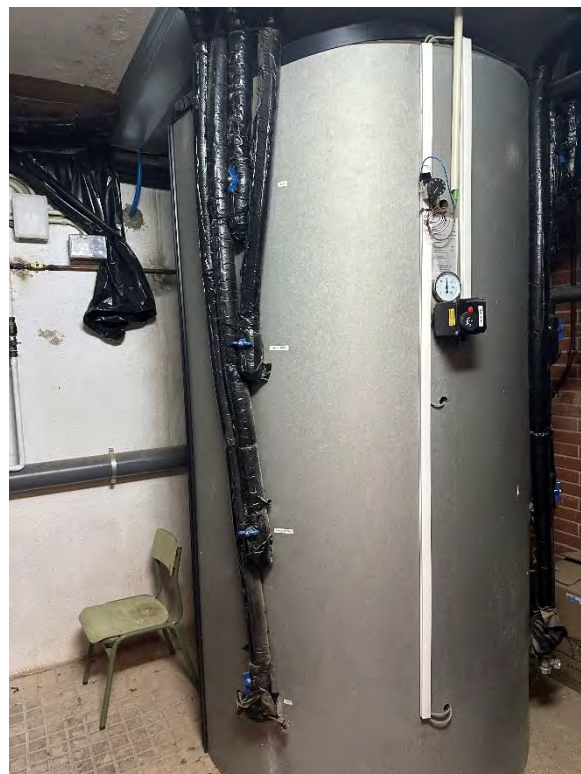
Dipòsit d'inèrcia de la caldera de gas propà (Edifici 1)
