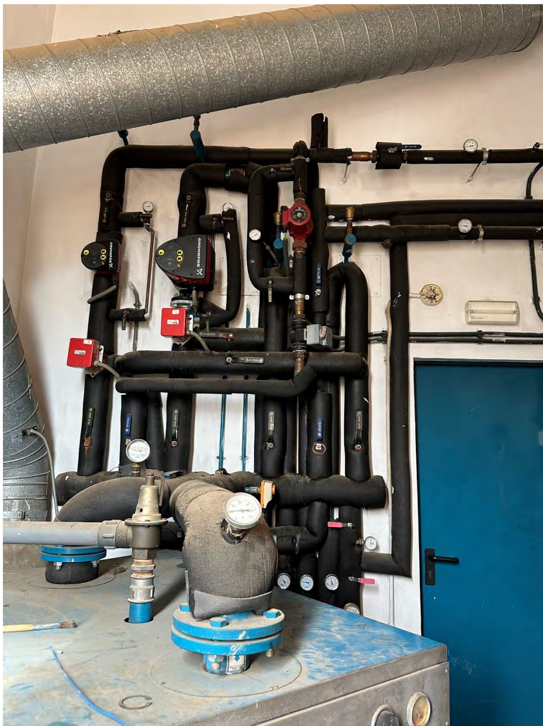
Caldera de Gasoil (Edifici 5)
