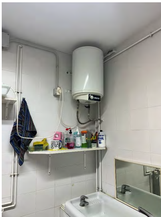
Termo elèctric menjador (Edifici 1)
