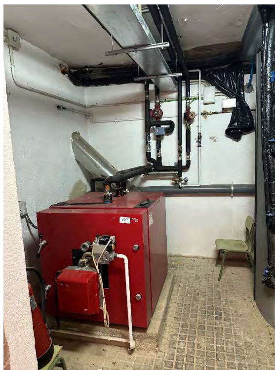
Caldera de gas propà (Edifici 1)
