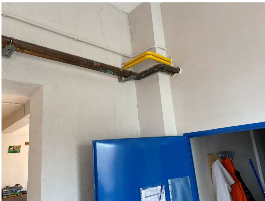
Canonades del circuit de calefacció existent (Edifici 5)
