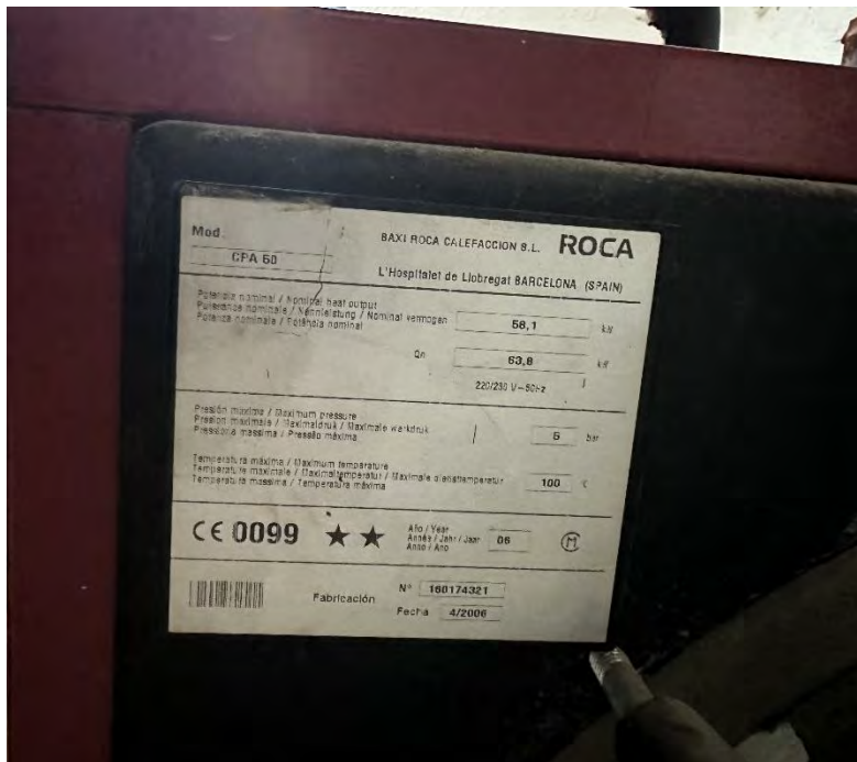
Placa de característiques de la caldera de gas propà (Edifici 1)
