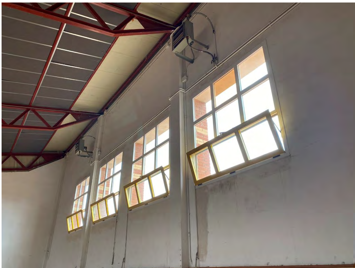
Fan-coils i finestres Gimnàs (Edifici 1)
